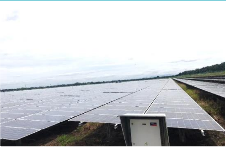
Susunan Panel Solar PV
